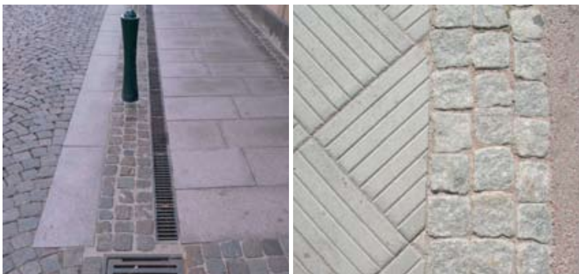
T.v. Säkra materialval och omsorg i utformning av detaljer påverkar gaturummets attraktivitet
