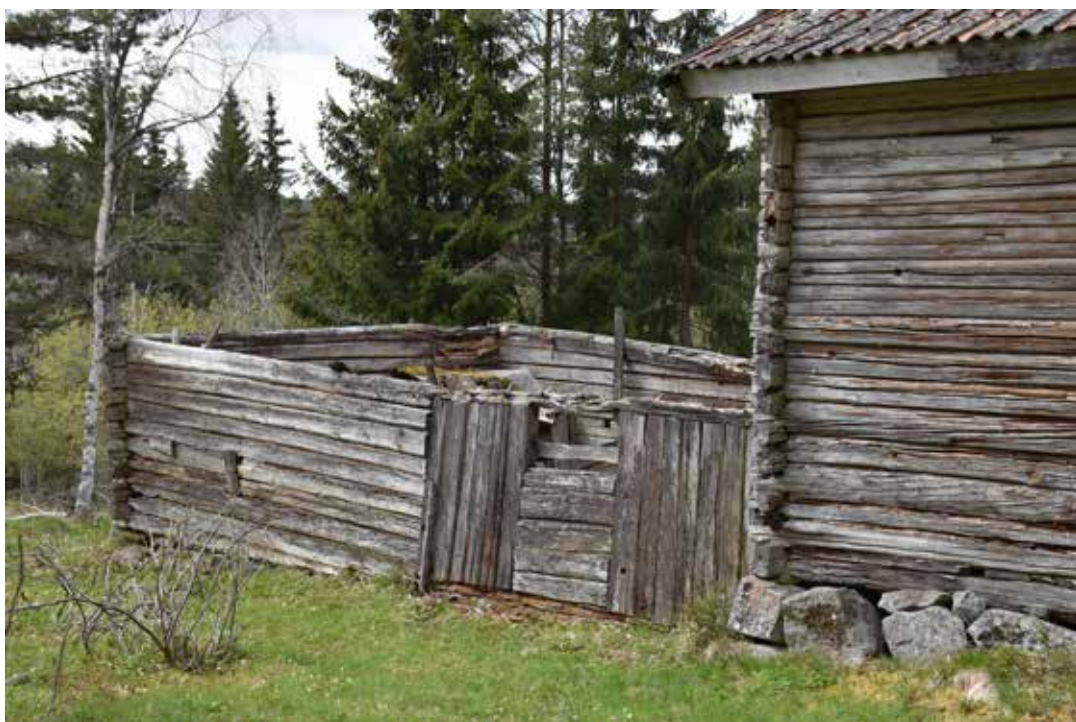
Fähus eller stall som stått taklöst under längre tid. Ullvi 14:15.
