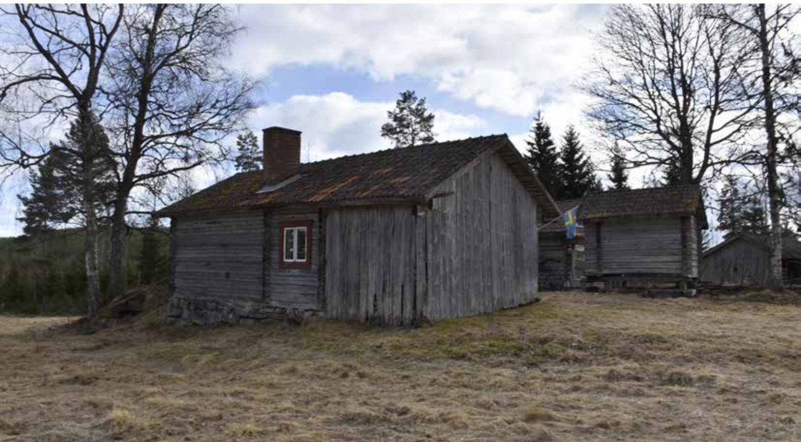
Bevarad fäbodstuga med tillbyggd vedbod mot kortsidan. De naturligt grånade timmerhusen är mycket karaktäristiska och kan berätta om timmerhuskulturen i Leksandsbygden i äldre tider, varför de har särskilt kulturvärde. Plintsberg 15:8.
